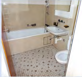
Asbesthaltiger Kleber hinter den Platten
