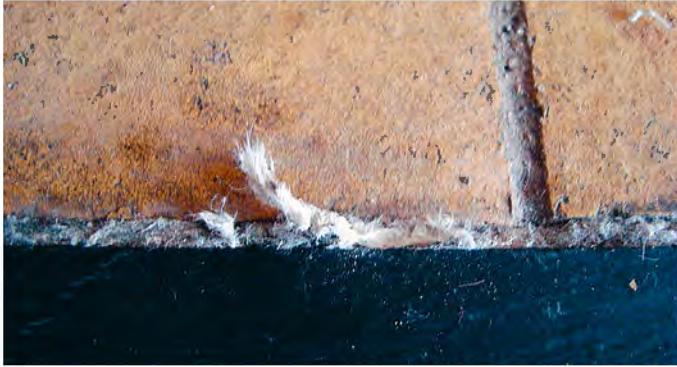
Asbestschnüre in einem Cheminée
