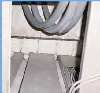
Brandabschottung mit Asbestkissen
