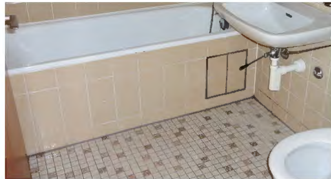
Platten mit asbesthaltigem Kleber
