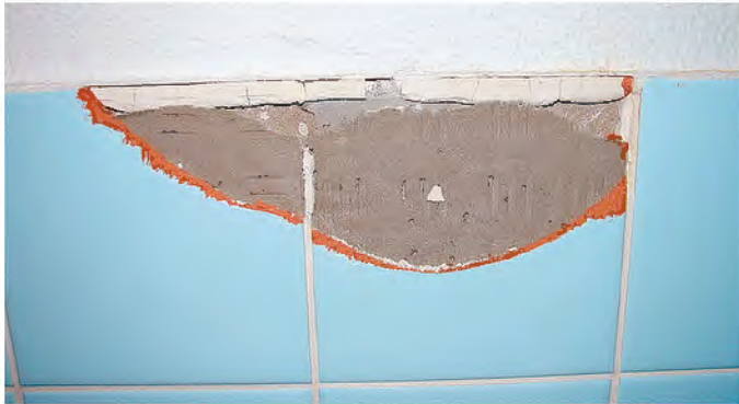
<1 % Chrysotil-Asbest im Kleber
