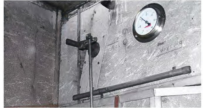
Lüftungskanal aus Asbestzementplatten
