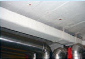
Kabelkanal aus Asbestzement
