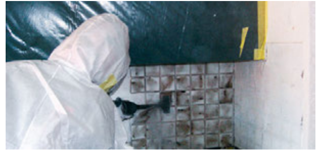
Entfernen nur durch ein anerkanntes Asbestsanierungsunternehmen
