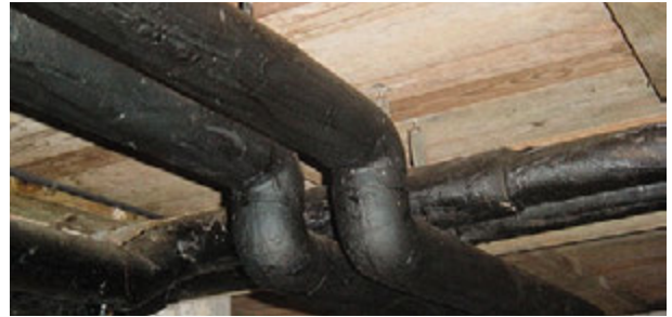
Rohrleitung mit asbesthaltigem Bitumenanstrich
