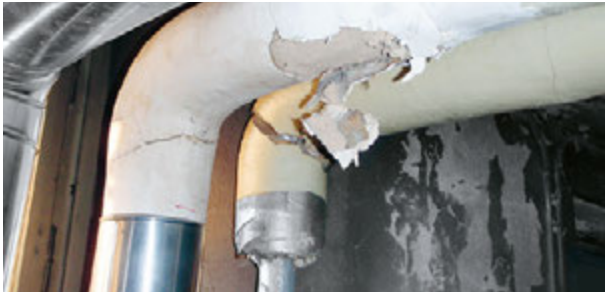
Rohrleitung mit asbesthaltigem Mörtel
