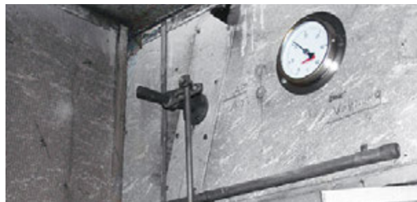
Lüftungskanal aus Asbestzementplatten
