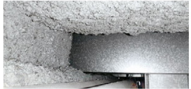
Spritzasbest als Brandschutz an Metallträger
