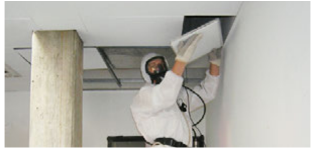
Entfernen nur durch anerkanntes Asbestsanierungsunternehmen
