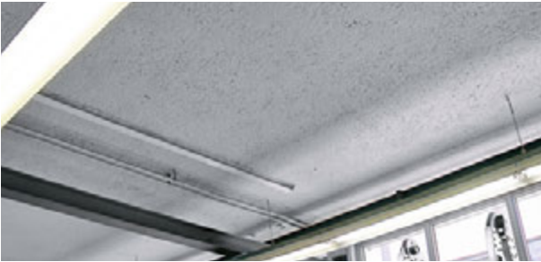
Spritzasbestbelag an Decke
