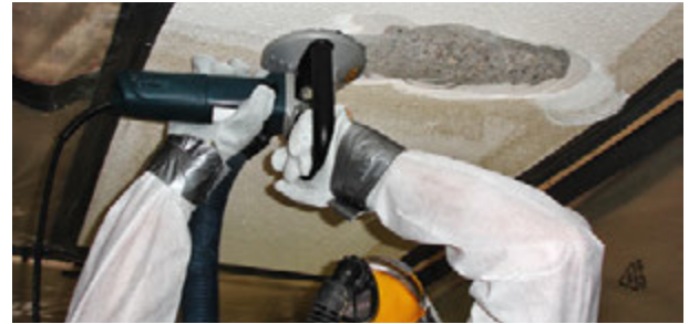
Entfernen nur durch ein anerkanntes Asbestsanierungsunternehmen
