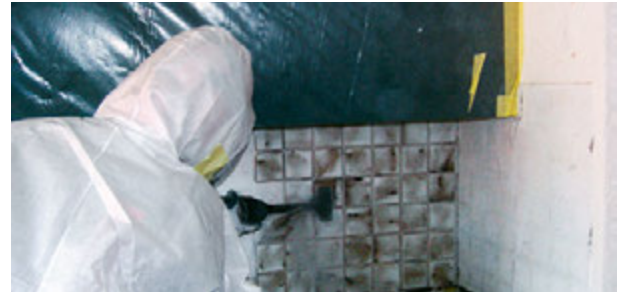
Entfernen nur durch ein anerkanntes Asbestsanierungsunternehmen
