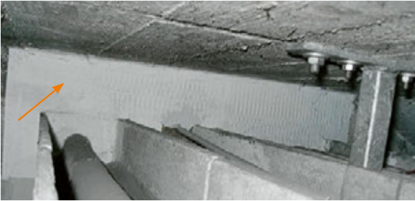
Kabeldurchbruch mit Brandabschottung
