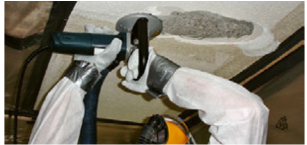
Entfernen nur durch ein anerkanntes Asbestsanierungsunternehmen
