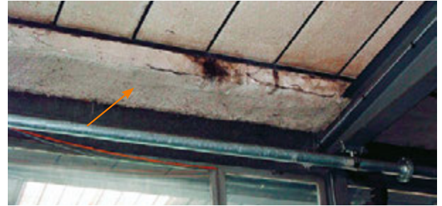
Spritzasbestisolation an Dachkonstruktion
