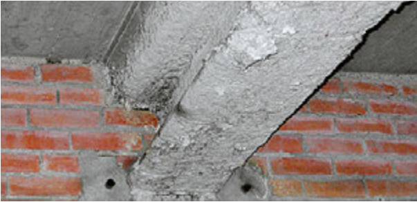
Spritzasbest an Stahlträger
