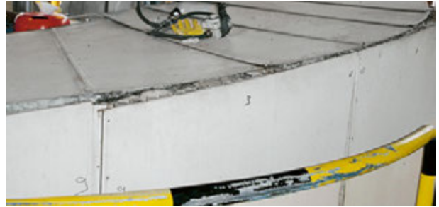
Asbesthaltige Dämmung hinter einer Verkleidung
