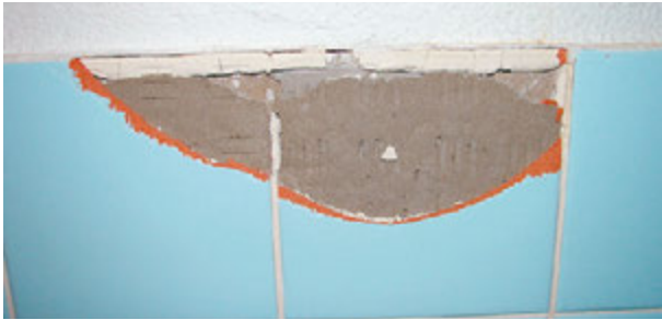
< 1 % Chrysotil-Asbest im Kleber
