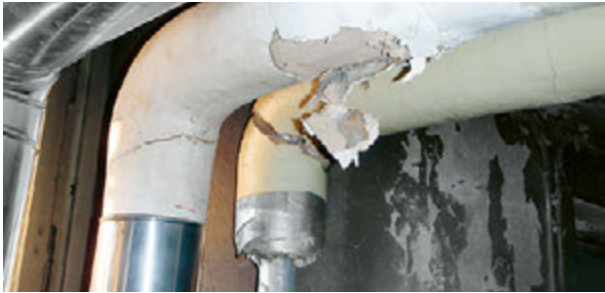
Rohrleitung mit asbesthaltigem Mörtel
