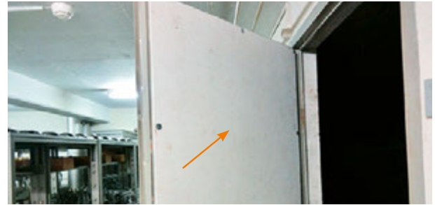
Brandschutz an Türe
