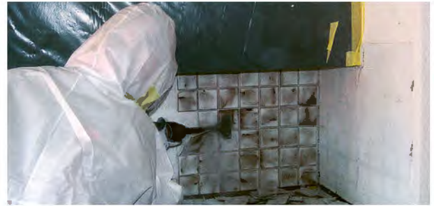
Entfernen nur durch anerkanntes Asbestsanierungsunternehmen
