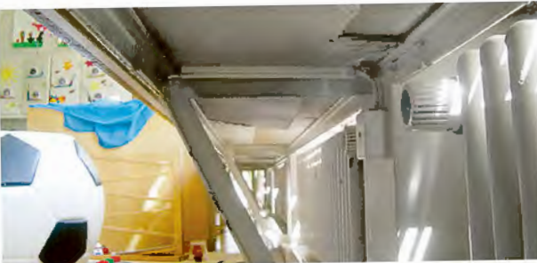
Leichtbauplatte unter Fenstersims...
