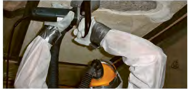
Entfernen nur durch anerkanntes Asbestsanierungsunternehmen
