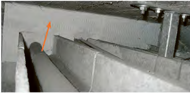
Kabeldurchbruch mit Brandabschottung
