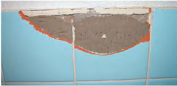
< 1 % Chrysotil-Asbest im Kleber
