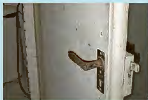
Brandschutztüre mit Asbestzement
