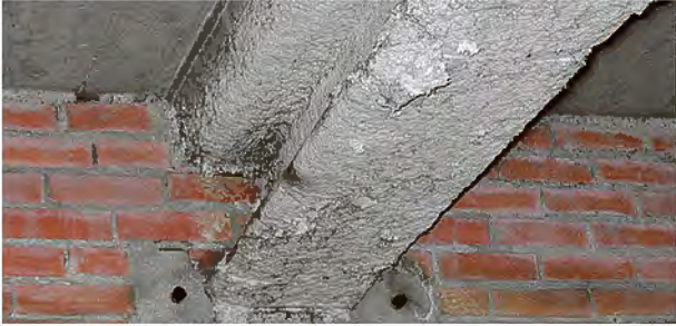
Spritzasbest an Stahlträger
