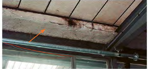
Spritzasbestisolation an Dachkonstruktion
