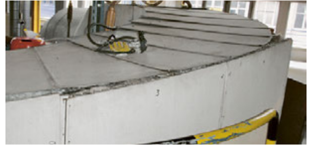
Asbesthaltige Dämmung hinter einer Verkleidung
