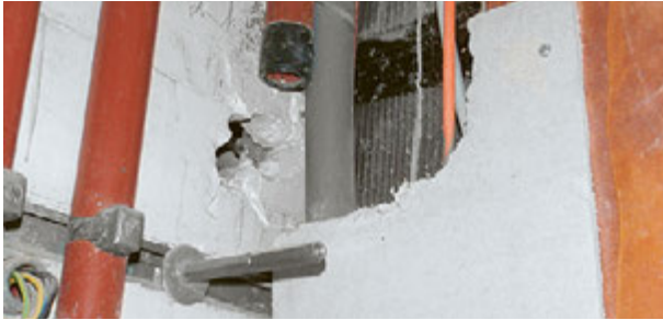
Brandschutzplatte in Steigzone
