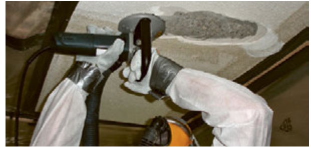
Entfernen nur durch ein anerkanntes Asbestsanierungsunternehmen
