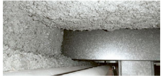
Spritzasbest als Brandschutz an Metallträger
