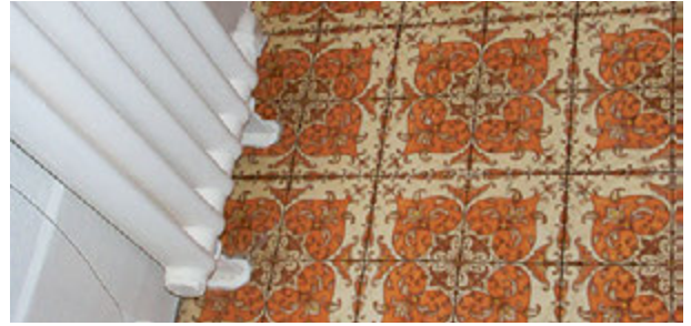
Typisches Muster eines mehrschichtigen asbesthaltigen Bodenbelags
