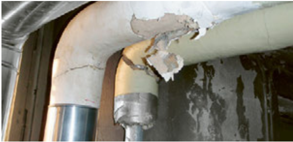
Rohrleitung mit asbesthaltigem Mörtel
