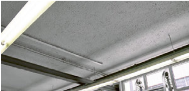
Spritzasbestbelag an Decke
