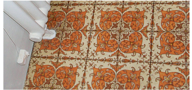
Typisches Muster eines mehrschichtigen asbesthaltigen Bodenbelags
