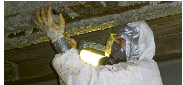
Entfernen nur durch anerkanntes Asbestsanierungsunternehmen
