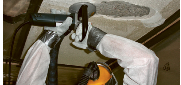
Entfernen nur durch anerkanntes Asbestsanierungsunternehmen
