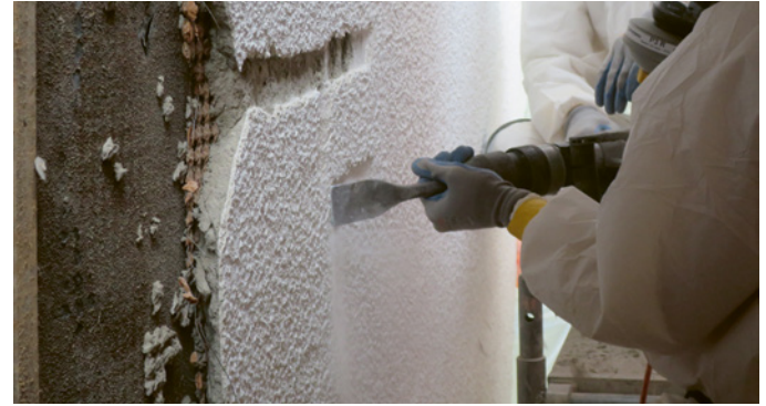
Entfernen nur durch anerkanntes Asbestsanierungsunternehmen
