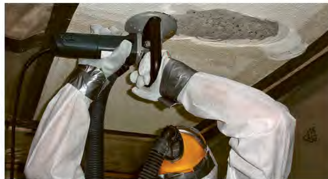
Entfernen nur durch anerkanntes Asbestsanierungsunternehmen
