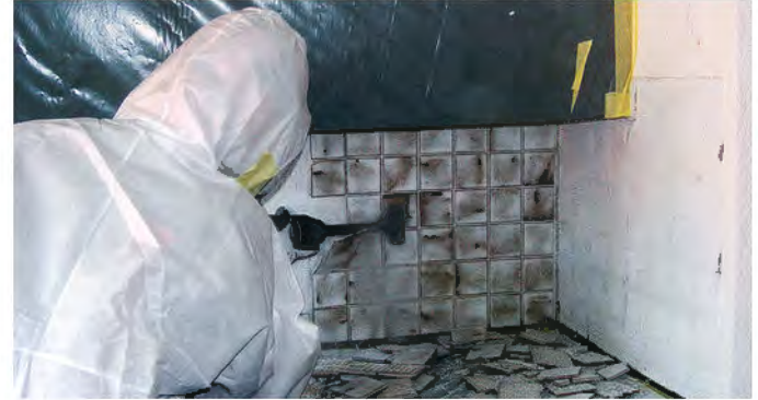
Entfernen nur durch anerkanntes Asbestsanierungsunternehmen
