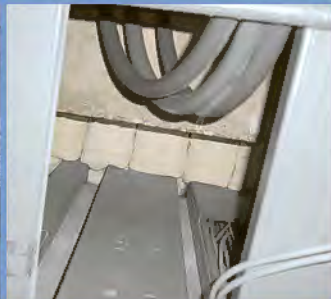
Brandabschottung mit Asbestkissen
