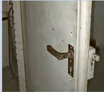
Brandschutztüre mit Asbestzement
