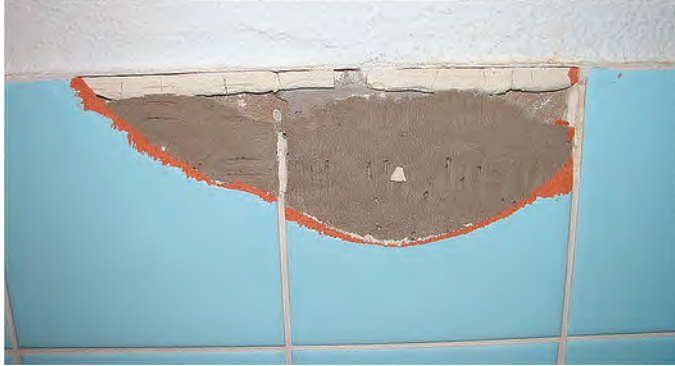
< 1% Chrysotil-Asbest im Kleber
