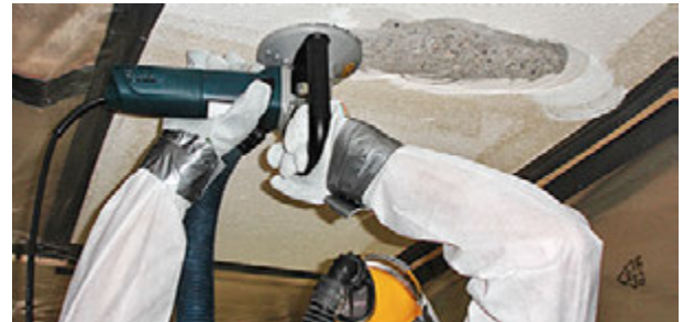
Entfernen nur durch anerkanntes Asbestsanierungsunternehmen
