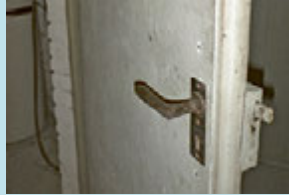
Brandschutztüre mit Asbestzement
