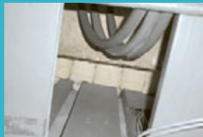
Brandabschottung mit Asbestkissen
