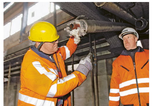
6 Die Mitarbeitenden müssen unerwartet auftretende kritische Stoffe der fachkundigen Person vor Ort melden.
