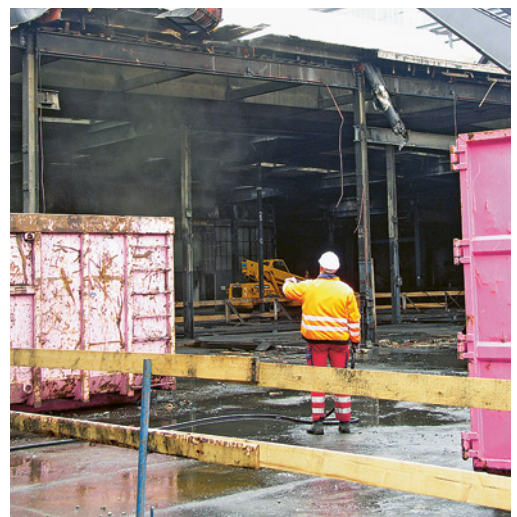
3 Die Gefahrenzone ist abgesperrt und durch Warnposten gegen Betreten gesichert.
