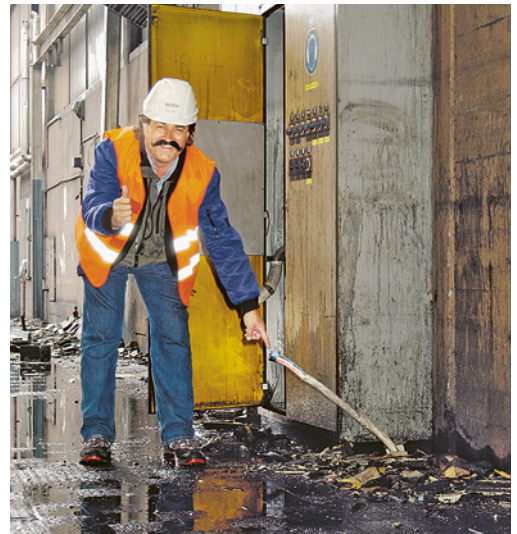
1 Mit den Rückbauarbeiten erst dann beginnen, wenn die Bestätigung vorliegt, dass alle Werkleitungen ausser Betrieb sind.
