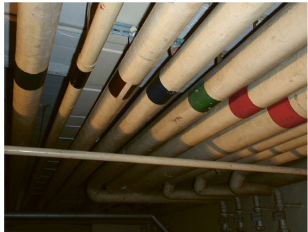
1 Rohrisolation mit asbesthaltiger Gipsbandage
