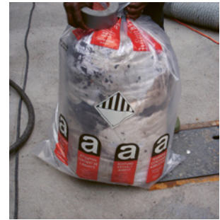
6 Kunststoff sack mit der Kennzeichnung «Asbest»
