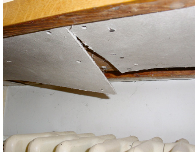
3 Asbesthaltige Leichtbauplatten als Brandschutzverkleidungen, z. B. bei Radiatoren
