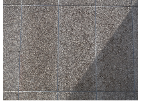
Fugendichtungsmasse Waschbeton, Gebäuediagnostik Siegart
